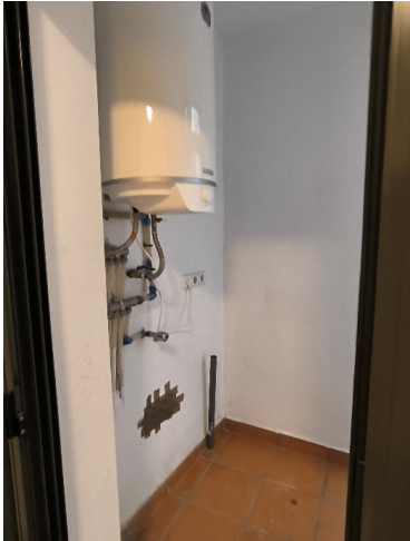
Escalfador a galeria tancada
